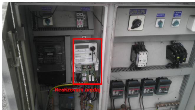
Sl. 4. Prototip uređaja instaliran u ormaru javne rasvjete.
